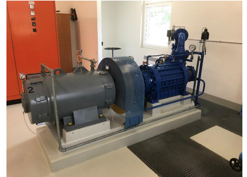
Sulzer-Pumpe nach Zone Berg, 180 kW Baujahr 1968, Förderhöhe 550 m.
